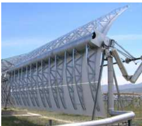
Kolektor słoneczny cylindryczno-paraboliczny zaprojektowany przez SENER
